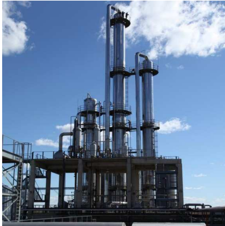
Figura 6.8 Instalación de la zona de destilación y purificación
