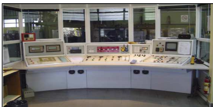
Fig. 17. Consola de Mando - Oficina de Operaciones de la empresa Ionics S.A.
